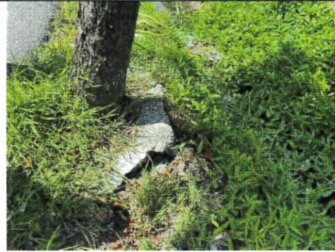
說明：部分小排旁的行道樹可能有傾倒的風險
