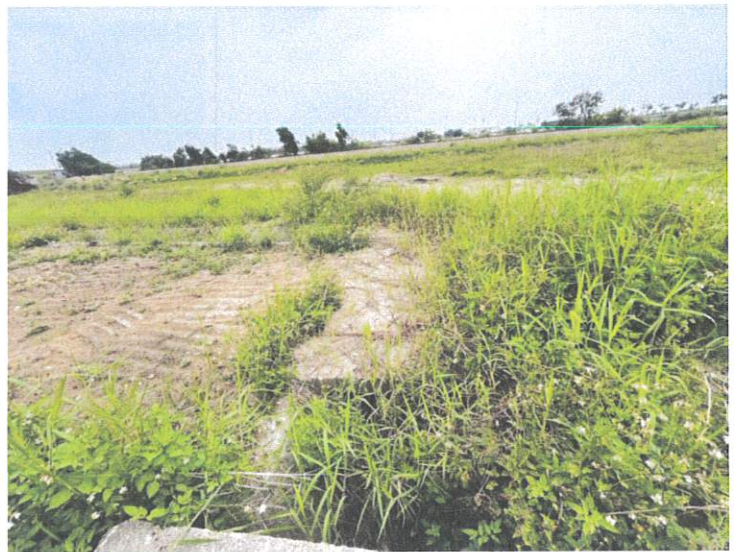
東崩埤小給 2-1 現況，舊式內面工 V 型溝。兩側有大面積人為擾動狀況。
